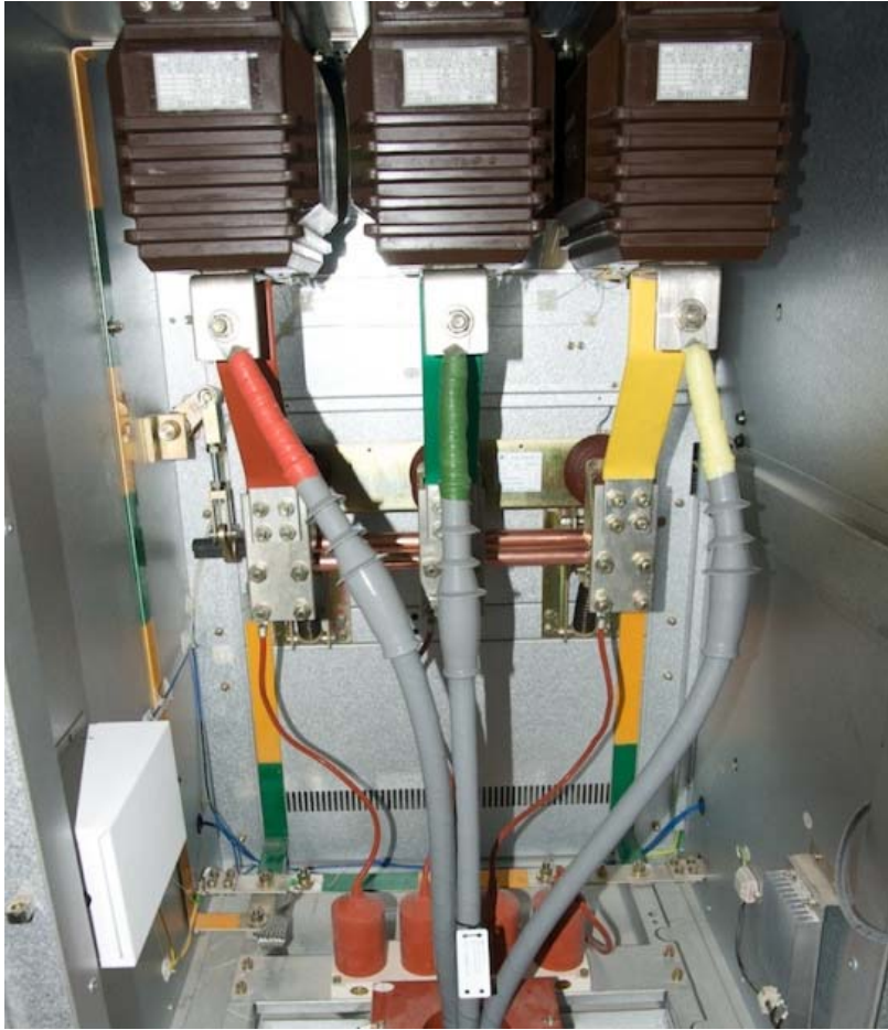
图 25: 开关柜内实图
