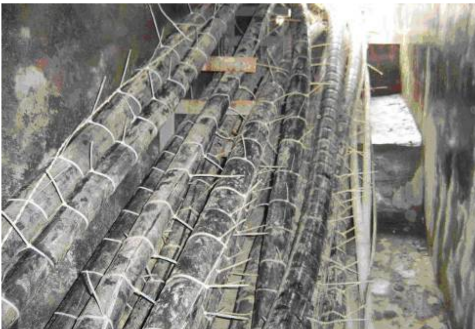
10KV、35KV 密集混杂地下电缆沟
