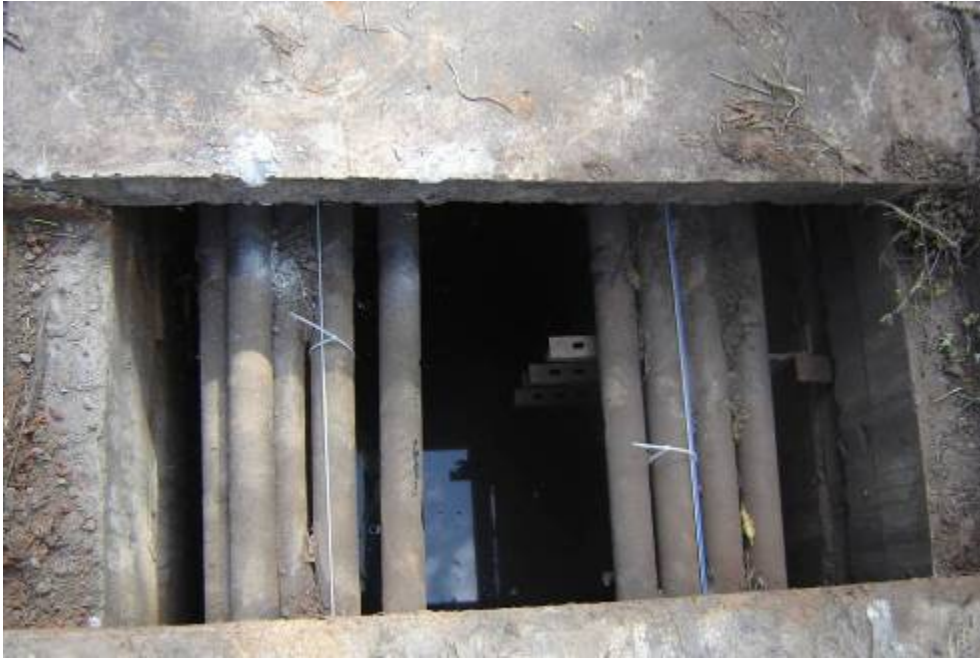
35KV 地下电缆沟
