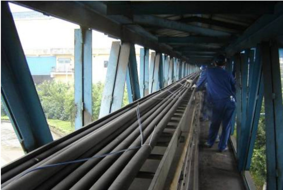
35KV 电缆桥架
