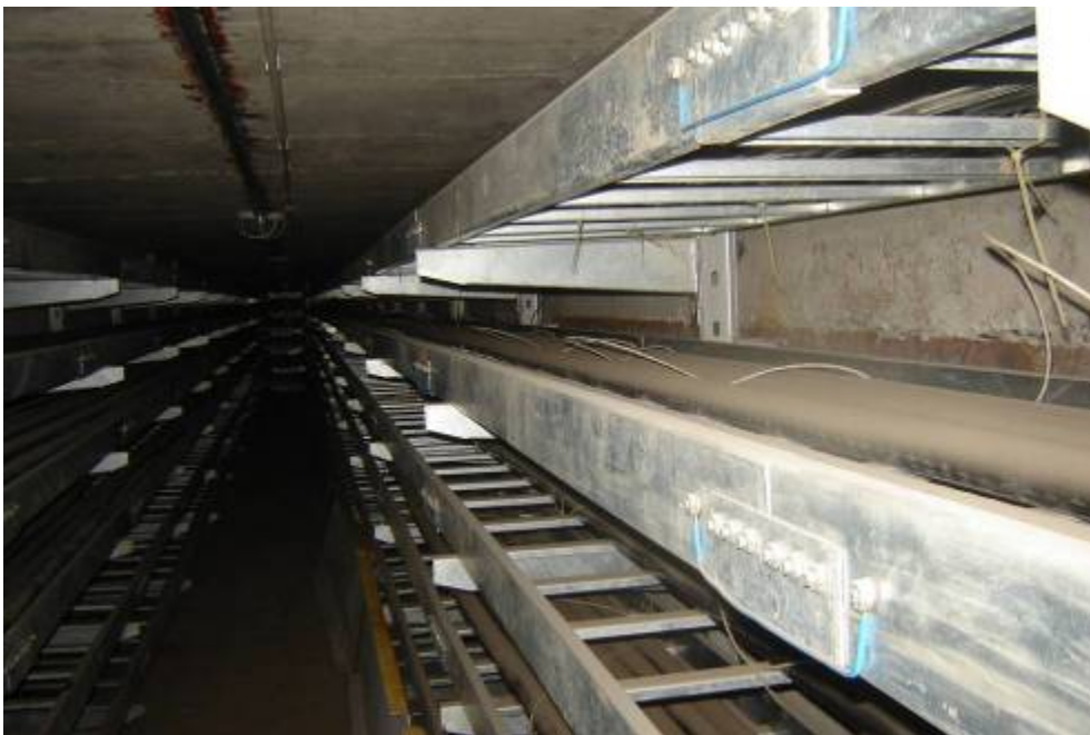
35KV 地下电缆桥架
